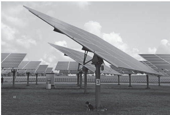
Солнечная электростанция «Токмак Солар Энерджи». Источник фото: НТЦ «Психея»
